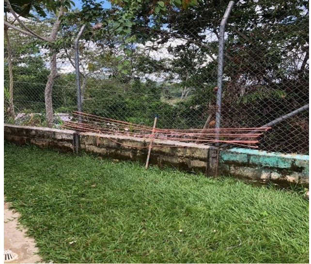
Foto 02: Zonas de acceso a zona verde, no cuentan con condiciones de protección y seguridad
