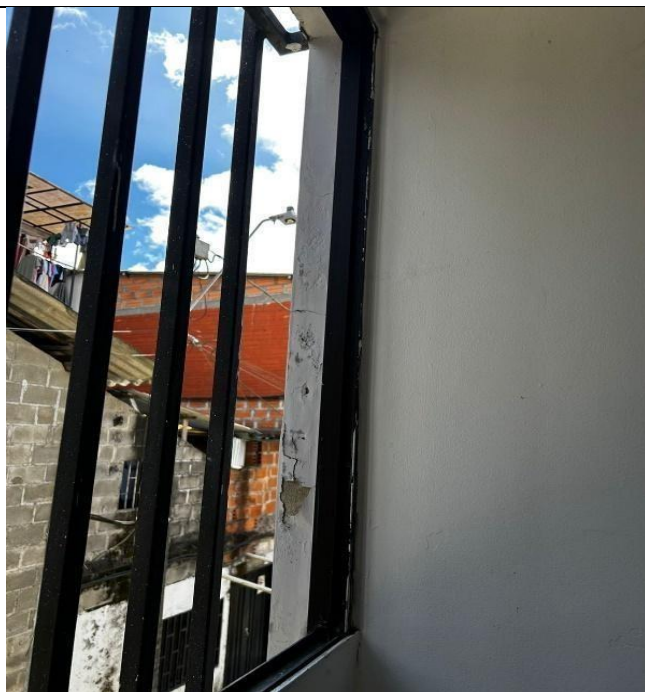
Foto 02: Ventanería del CDI Sembrando Amor, se evidencia desgaste producto de la humedad, ausencia de sistemas de impermeabilización, y falta de vidrios en la ventanería.
