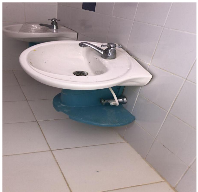
Foto 04: Baños y lavamanos insuficientes y en mal estado.
