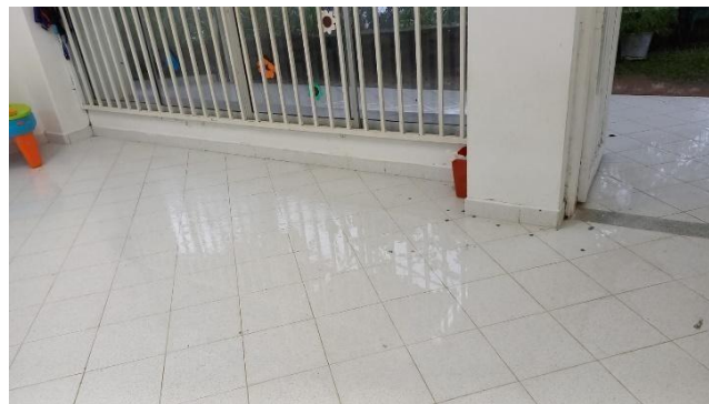
Foto 06: Sala de desarrollo con agua luego de aguacero
