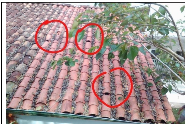
Foto 05: Techo con tejas incompletas o agrietadas.
