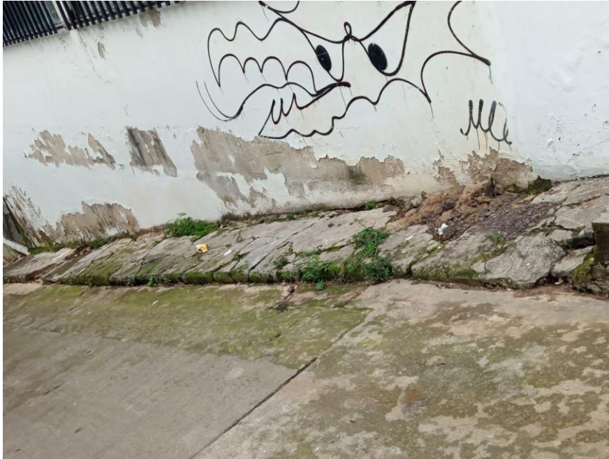
Foto 03: estado actual de la fachada, se puede evidenciar alto grado de deterioro en los andenes perimetrales, de igual manera se evidencia la presencia de humedades y desgaste en la fachada producto de falta de mantenimiento.
