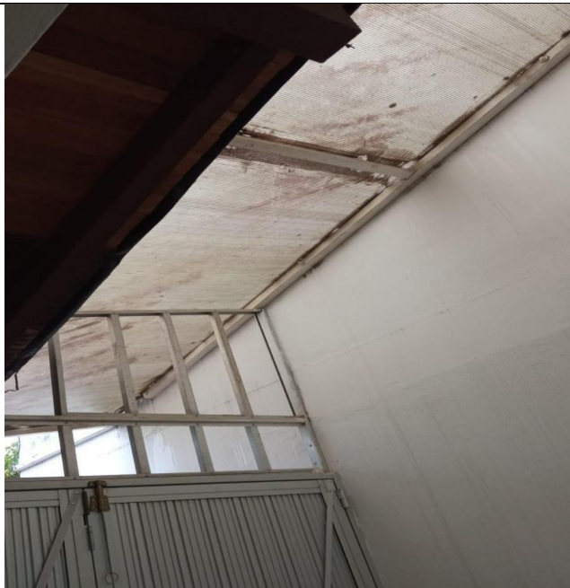
Foto 03: Techos y cubiertas en mal estado
