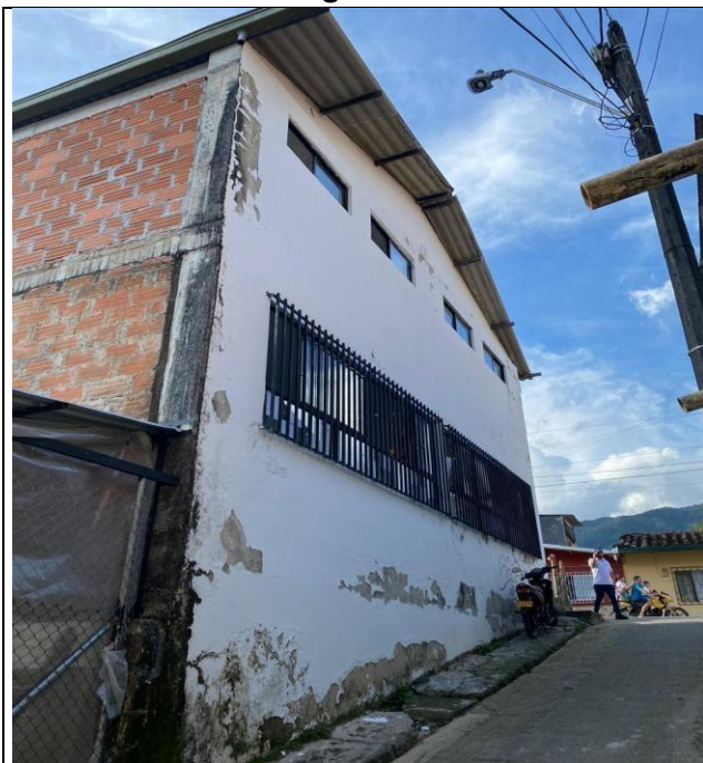
Foto 01: Fachada del CDI sembrando amor (casco urbano) en ella se evidencia el evidente estado de deterioro producto de la exposición a las inclemencias climáticas y la falta de mantenimiento.
