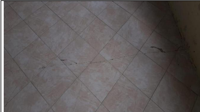
Foto 01: Fisuras en el piso del salón EXPLORADORES
