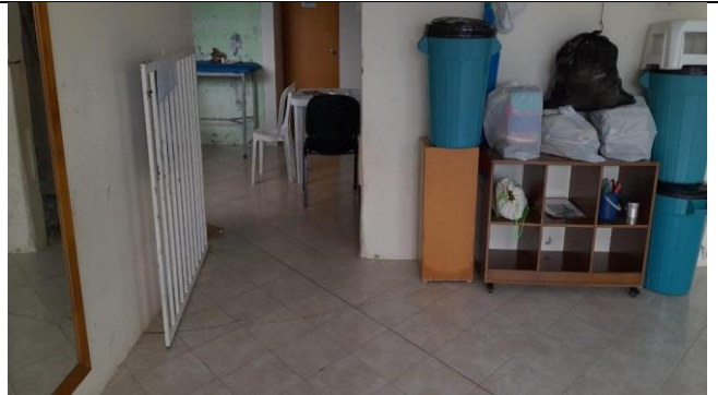
Foto 02: Fisuras en el piso del salón EXPLORADORES
